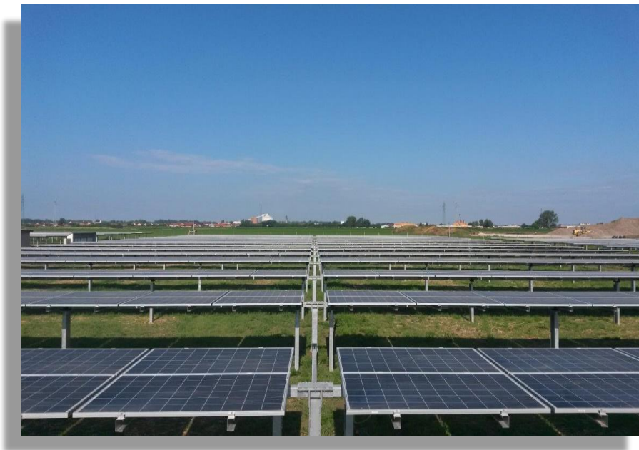
Slika 19. Fotonaponska elektrana Županja - 1 MM
