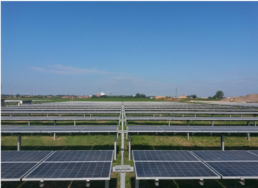
Slika 19. Fotonaponska elektranu Županja - 1 MM
