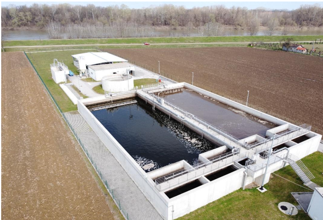
Slika 21. Pročistač otpadnih voda u Županji (2)
